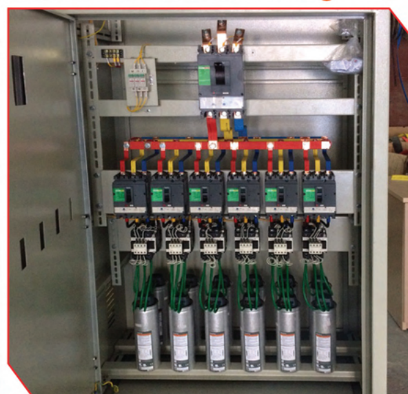
Tủ tụ bù Capacitor cabinets
